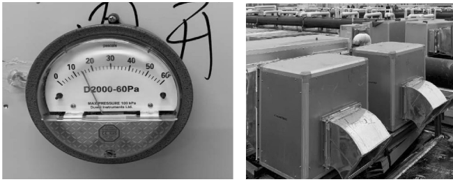
图4 缓冲间微压差计及泄压风机
